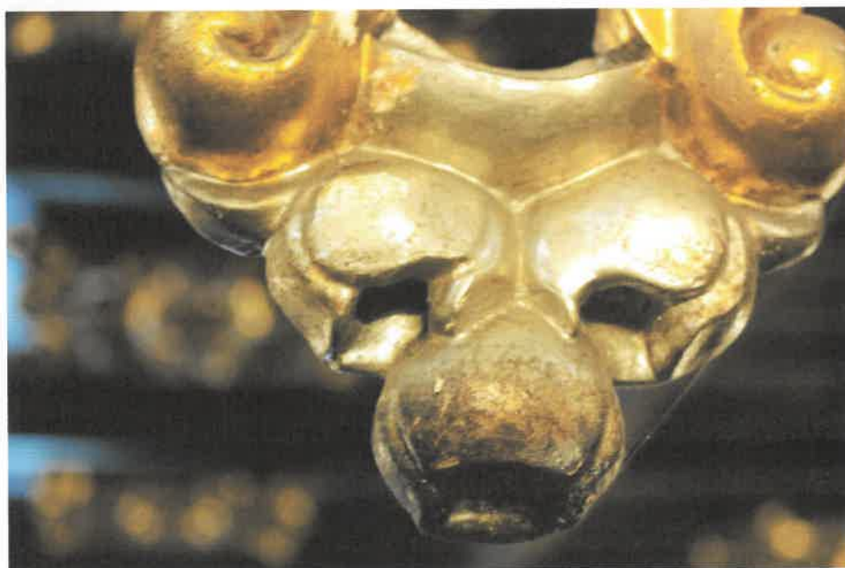
Fragment dekoracji balustrady- widoczne są zabrudzenia oraz uszkodzenia i przetarcia pozłoty
