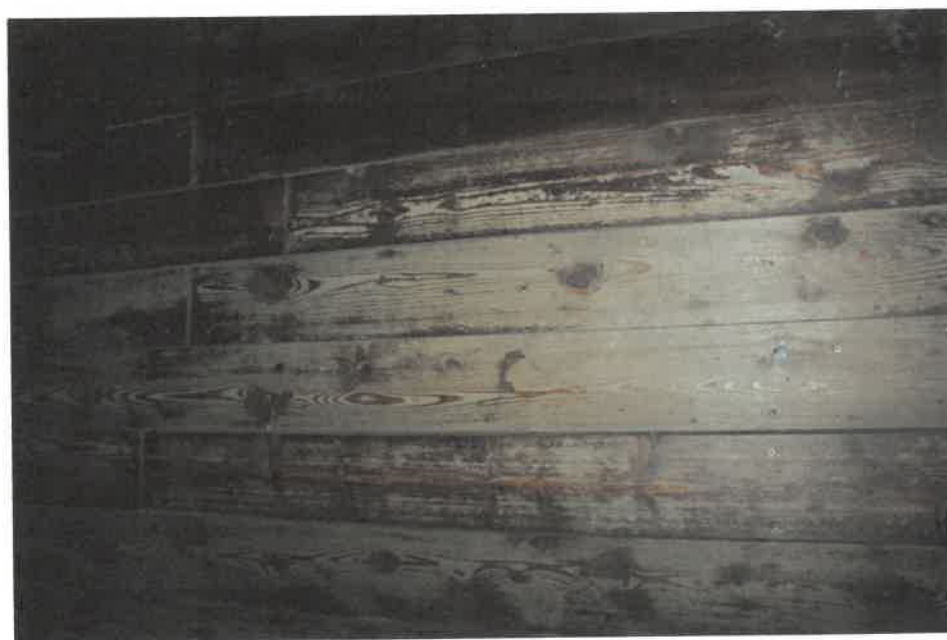
Fragment podłogi chóru- widoczne są znaczne przetarcia wierzchniej warstwy barwnej i mechaniczne uszkodzenia powierzchni drewna
