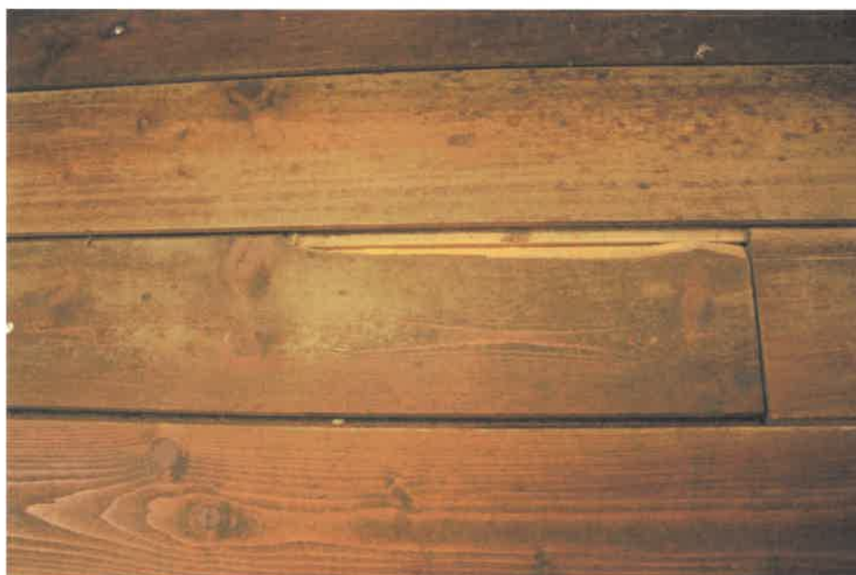
Fragment podłogi chóru- widoczne są znaczne przetarcia wierzchniej warstwy barwnej i mechaniczne uszkodzenia powierzchni drewna oraz ubytki drewna
