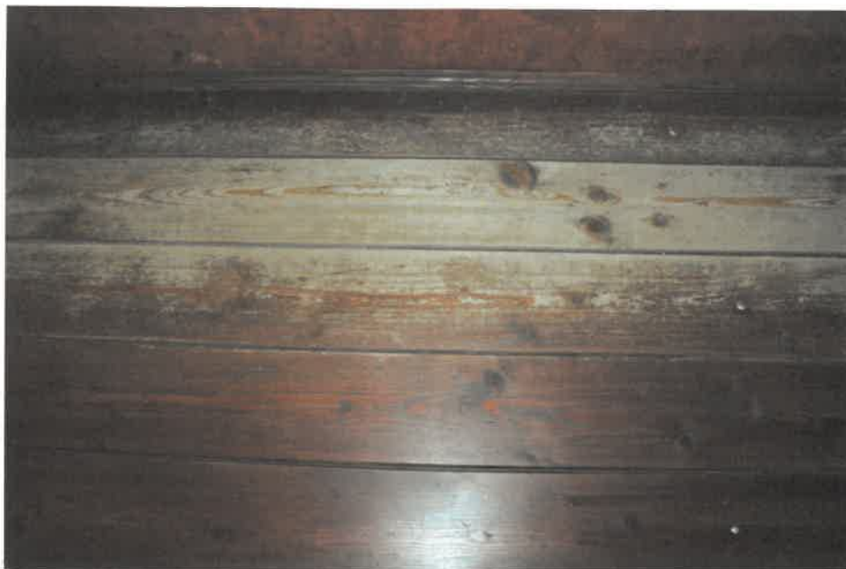
Fragment podłogi chóru- widoczne są znaczne przetarcia wierzchniej warstwy barwnej i mechaniczne uszkodzenia powierzchni drewna oraz szerokie szczeliny w partii spoin między deskami
